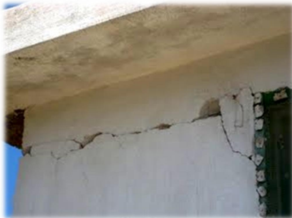
15) Daños en casa – habitación(Cahuaré) tomada del sitio https://sites.google.com/site/denunciacalera/ el 11 de diciembre de 2011
